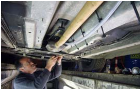
Raccordement de l'ensemble des composants
